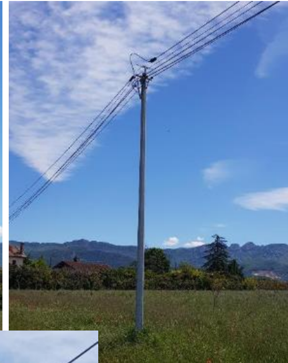
Poteau télécom métal
